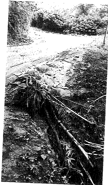
Foto 05: Situação real da pista. Necessidade de sistema de drenagem pluvial;
